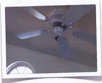
Electric fan broken
